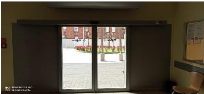
Zdjęcie nr 1 –nieskontrastowane, szklane drzwi wejściowe.
