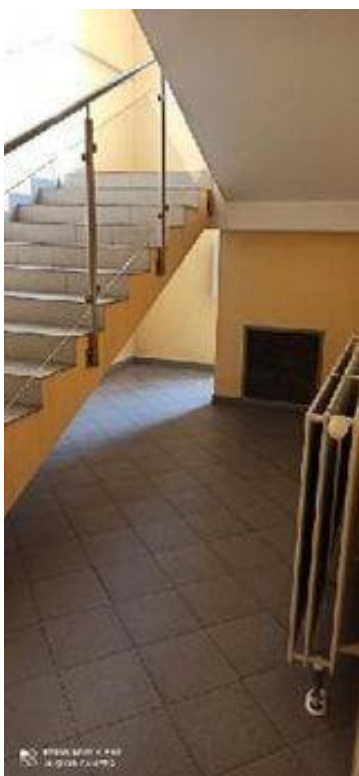
Zdjęcie nr 5. Przykładowe niezabudowane schody.
